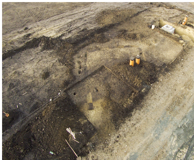
Obr. 13. Starovice. Základy domu z období starší doby bronzové, pohled od jihovýchodu. Foto R. Bíško.
