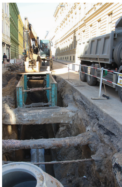
Obr. 6. Brno, Francouzská. Ilustrační záběr od východu na rekonstrukci úseku kanalizace západně od křižovatky s Přadláckou ulicí. Foto Archaia Brno z. ú.
