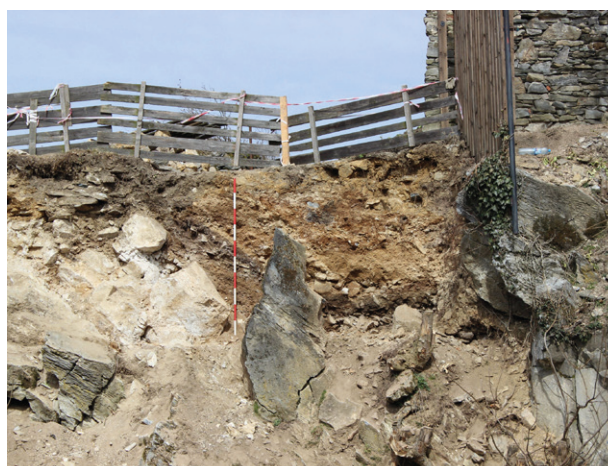
Obr. 64. Hrad Sovinec – nalezená západní část středověkého hradního příkopu. Abb. 64. Burg Sovinec – der westliche Teil des mittelalterlichen Burggrabens.
