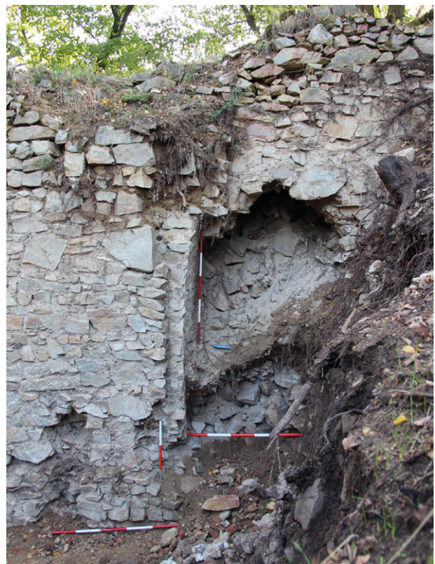
Obr. 49. Jamolice, Hrad Templštejn. Tzv. zadní palác. Pohled od západu na částečně destruovaný vchod do zatím nedokumentované budovy východně od paláce.
