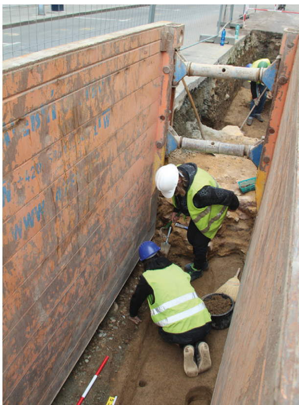
Obr. 8. Brno, Dominikánské náměstí, Panenská ulice, Veselá ulice (A13/2018). Archeologické práce v linii nové kanalizace na Veselé ulici. Pohled od severu.
