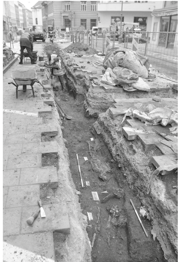
Obr. 15. Brno, Běhounská ulice, Jakubské náměstí (A106/2016). Pohled od západu na výzkum hlavní linie výkopu.
