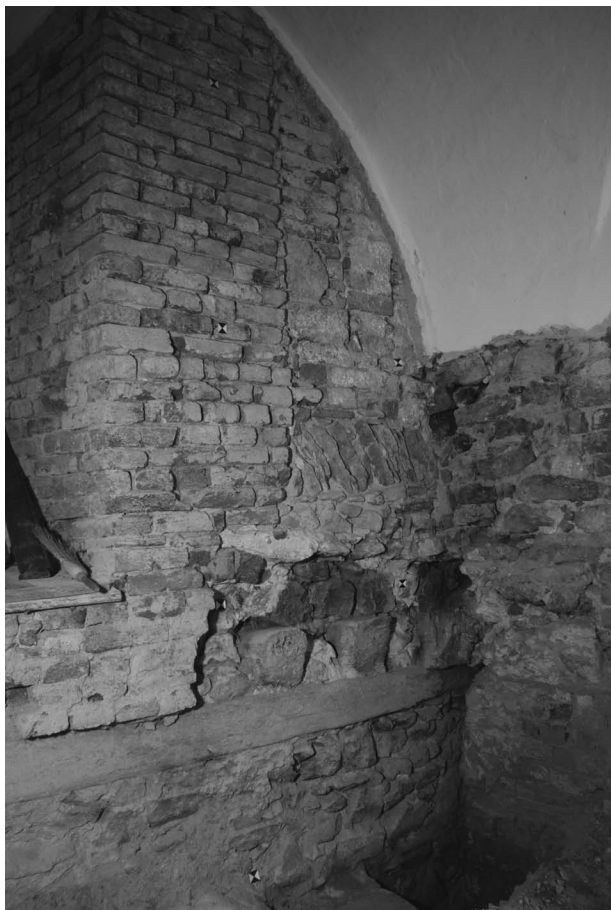
Obr. 57. Jihlava, Masarykovo náměstí 15 a 16. Odkryté zhlaví stropních trámů gotického suterénu domu č. 16 (r. 1259/1260, fáze III). Archiv společnosti Archaia Brno, o. p. s., foto i. č. 352-2012.
