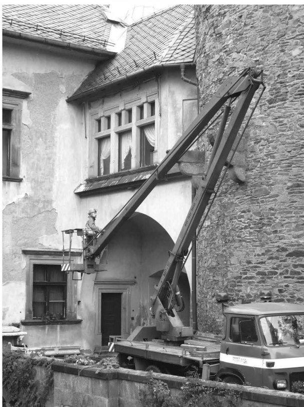
Obr. 124: Hrad Šternberk, výstup na věž pomocí vysokozdvizžné plošiny (foto J. Grégr). Abb. 124: Burg Šternberk, Betreten des Turms mit Hilfe der LKW-Arbeitsbühne (Foto J. Grégr).
