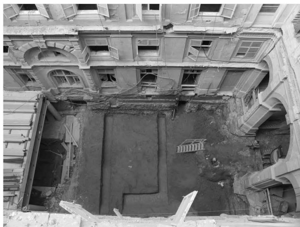
Obr. 42: Šilingrovo náměstí 2 (A005/2006). Pohled od východu na sondy v prostoru příkopu městského opevnění. Abb. 42: Platz Šilingrovo náměstí 2 (A005/2006). Blick von Osten auf die Suchschnitte im Raum des Grabens der Stadtbefestigung.
