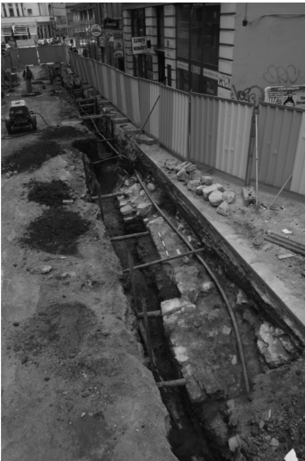
Obr. 6. Běhounská, Brandlova, Joštova, Koží, Moravské náměstí, Rooseveltova, Solniční (A061/2009). Zdivo západní stěny Běhounské brány ve výkopu vodovodu.
