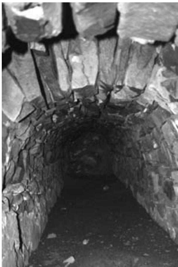
Obr. 99. Opava, Horní náměstí, Rybí trh. Páteřní stoka kanalizační sítě z 19. století (foto P. Skalická).
