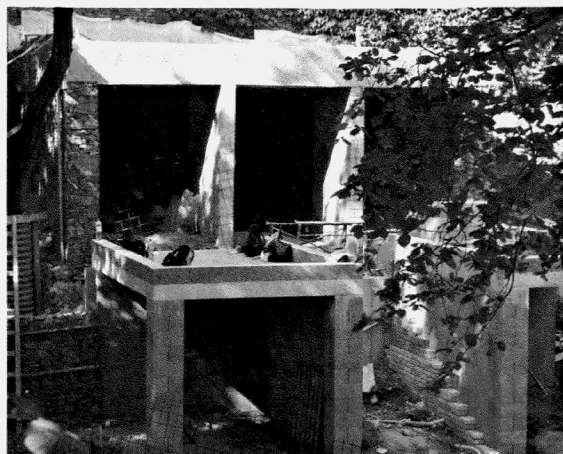
Obr. 17. Přerov-Předmostí Ib, expoziční pavilon během výstavby. Přerov Předmostí Ib, the exposition pavilion during construction.
