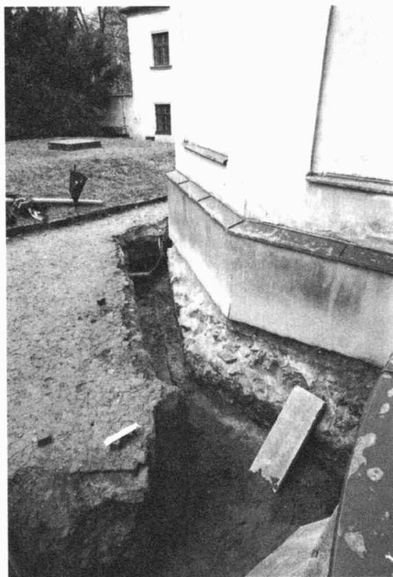
Obr. 55. Ulice Božetěchova, kostel Nejsvětější Trojice (A110/2003). Výkop pro odvlhčení zdivu kostela. Božetěchova-Straße, Dreifaltigkeitskirche (A110/2003). Aushübe zur Entfeuchtung des Kirchenmauerwerks.
