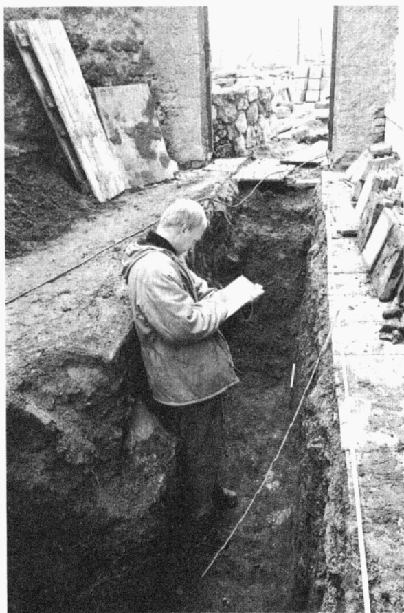
Obr. 21. Petrov (A082/2002). Dokumentace situací ve výkopu kanalizace. Petrov (A082/2002). Dokumentation der Befunde in dem Kanalisationsaushub.
