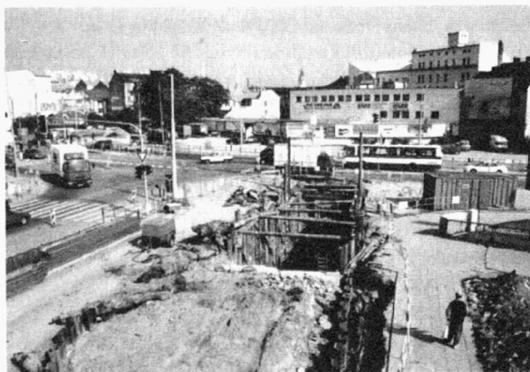
Obr. 4. Ulice Dornych (A006/2002). Celkový pohled na úsek kolektoru v křižovatce ulic Dornych a Úzká. Dornych-Straße (A006/2002). Gesamtansicht des Kollektorabschnitts auf der Straßenkreuzung Dornych-Úzká.
