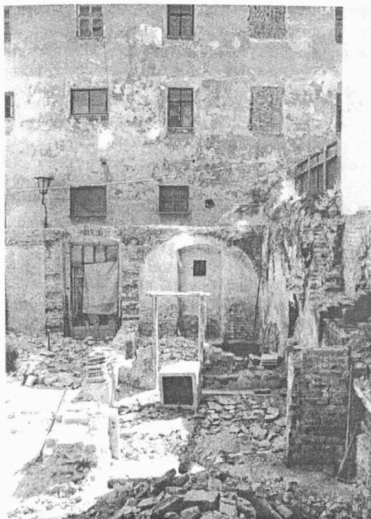
Obr. 20. Františkánská 9 (A224/2000), pohled od severu na demolovanou část domu při uliční čáře.
